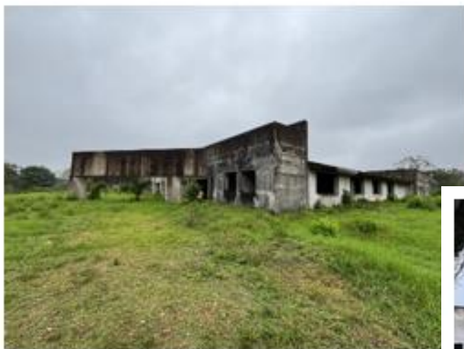
Supervisión Hospital de Misantla, Misantla, Ver. Abandonado desde el año 2010
